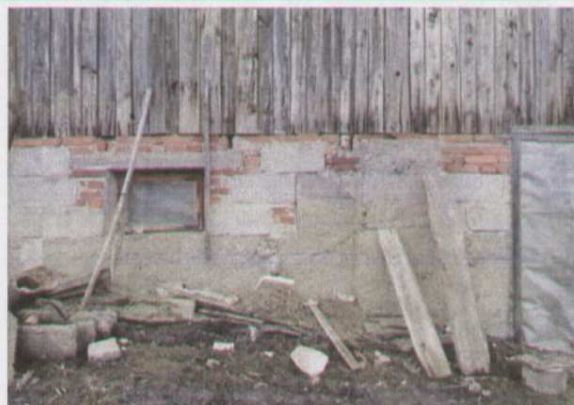
Fot.3 Spękany budynek gospodarczy przy ul. Rolniczej 15
