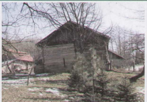
Fot. 4 Przechylony budynek drewniany (posesja bn1)
