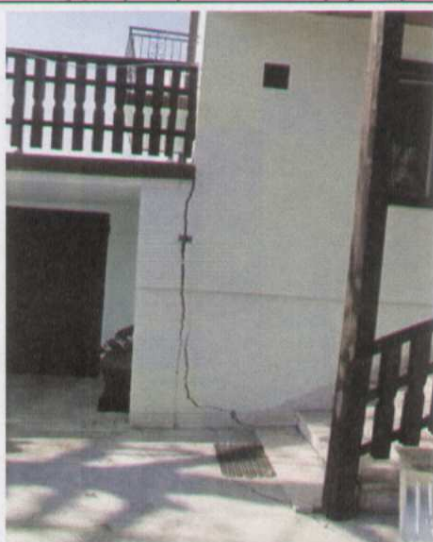
Fot.9 Spękany budynek mieszkalny (posesja 32)
