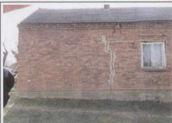
Fot.7 Spękany budynek mieszkalny (posesja 23)
