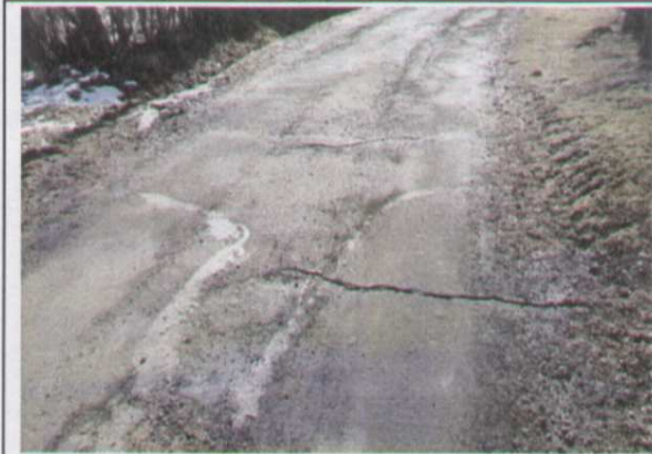
Fot.3 Spękana nawierzchnia asfaltowa na ul. Gajowej
