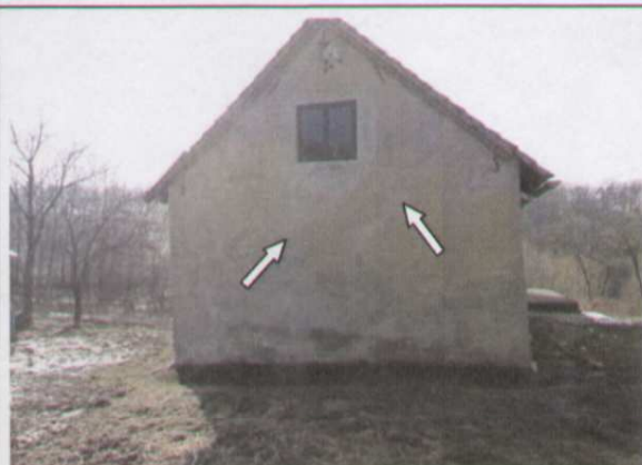
Fot.8 Spękany budynek mieszkalny (posesja 32)
