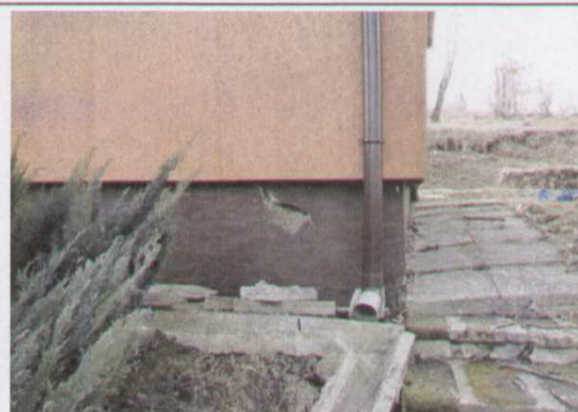
Fot.5 Spękania podmurówki budynku mieszkalnego przy ul. Rolniczej 21
