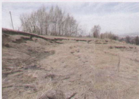
Fot. 1 Skarpa główna (południowa część osuwiska)
