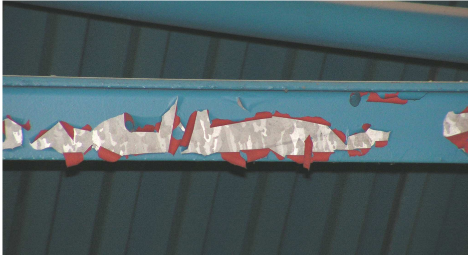
Rys. 5-3. Złuszczenie farby na górnym pasie wiązara .
