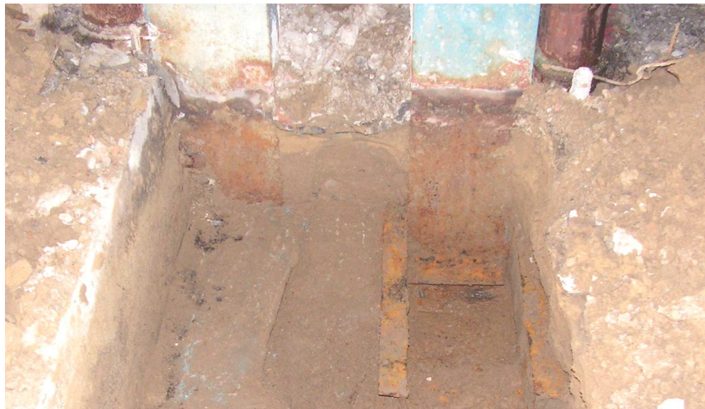
Rys. 5-4. Korozja słupów 8C i 8D w osiach poniżej poziomu gruntu. Widoczna korozja wżerowa.
