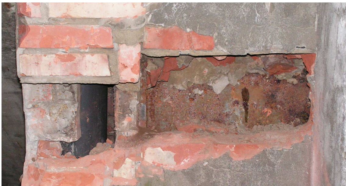
Rys. 5-5. Odkrywka obmurowanego słupa głównego w osiach 8E. Widać mokry gruz ceglany w pachwinie dwuteownika i skorodowany słup.
