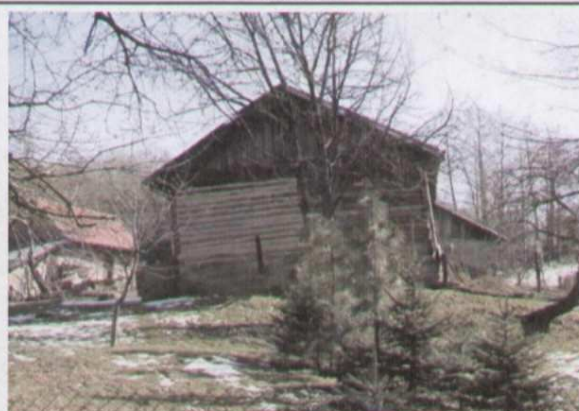
Fot. 4 Przechylony budynek drewniany (posesja bn1)
