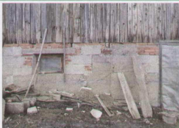
Fot.3 Spękany budynek gospodarczy przy ul. Rolniczej 15
