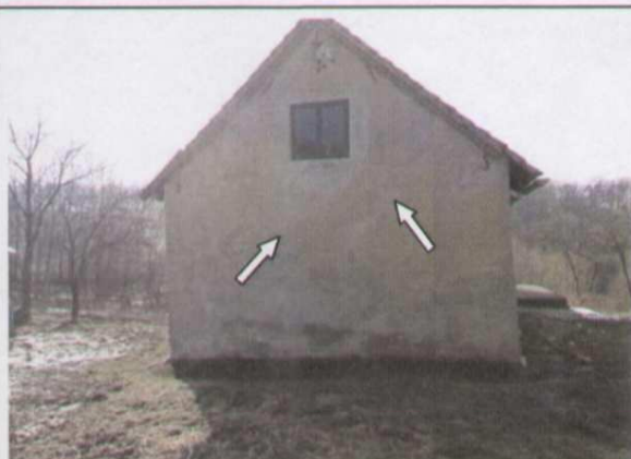
Fot.8 Spękany budynek mieszkalny (posesja 32)
