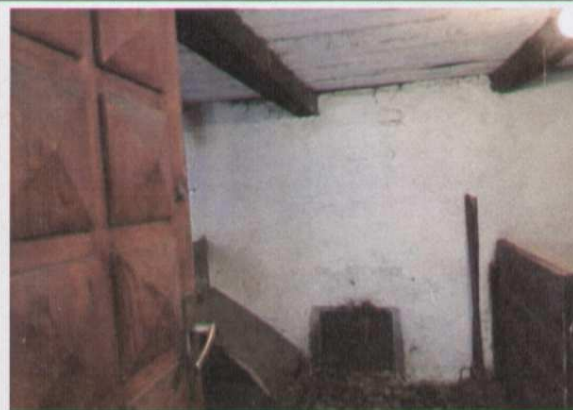
Fot.4 Spękany budynek gospodarczy przy ul. Rolniczej 17 (wnętrze budynku)
