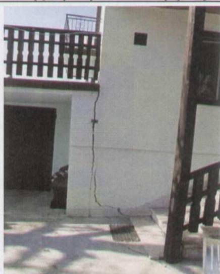
Fot.9 Spękany budynek mieszkalny (posesja 32)
