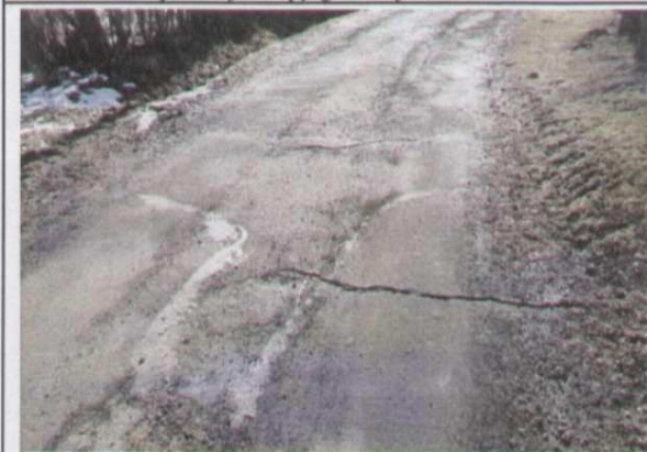
Fot.3 Spękana nawierzchnia asfaltowa na ul. Gajowej
