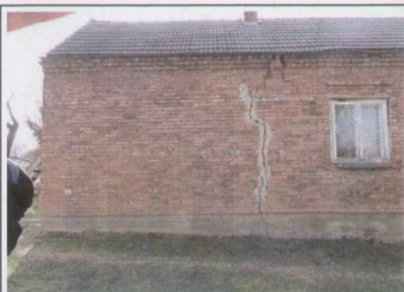
Fot.7 Spękany budynek mieszkalny (posesja 23)
